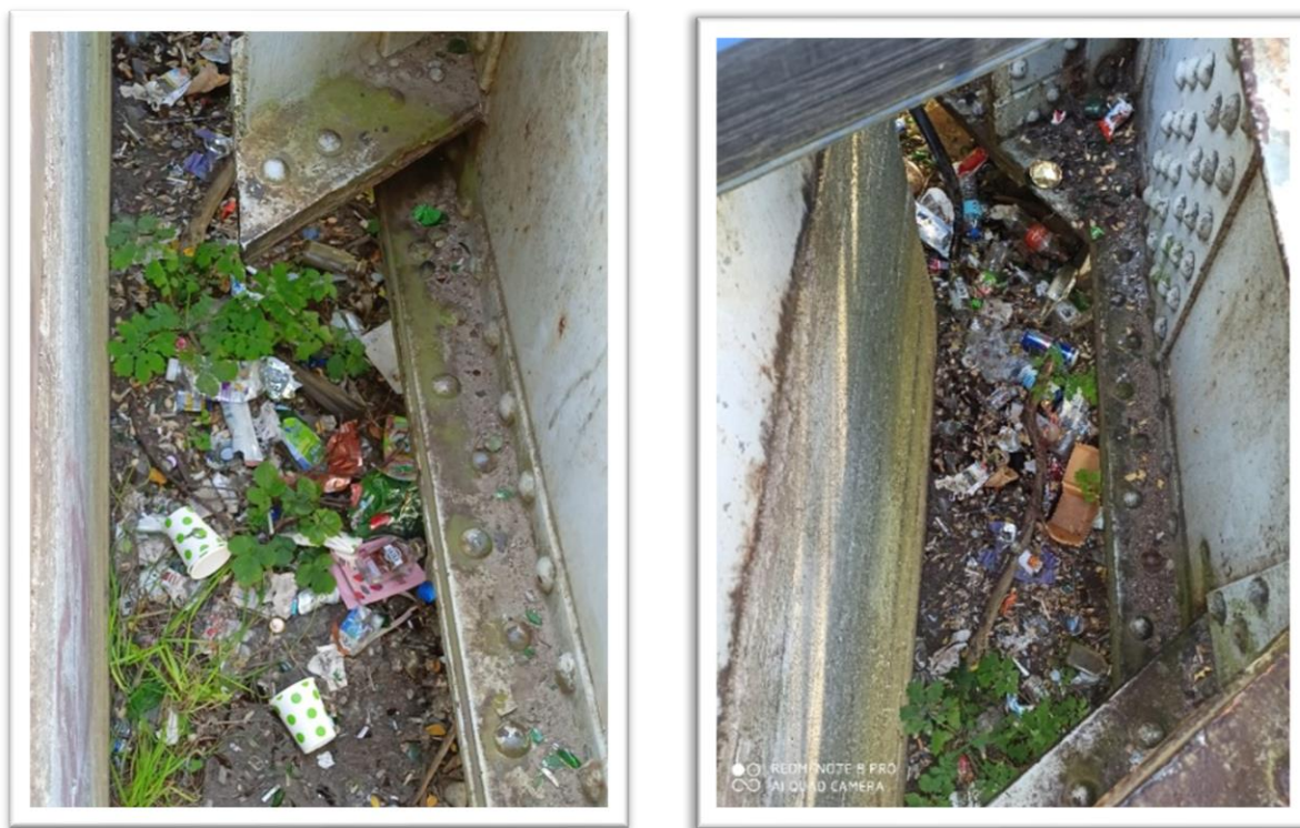
Rysunek 8 Niezagospodarowane odpady zalegające na podobszarze rewitalizacji 1 (Wąsosz Południe) przy moście kolejowym nad rzeką Barycz.
