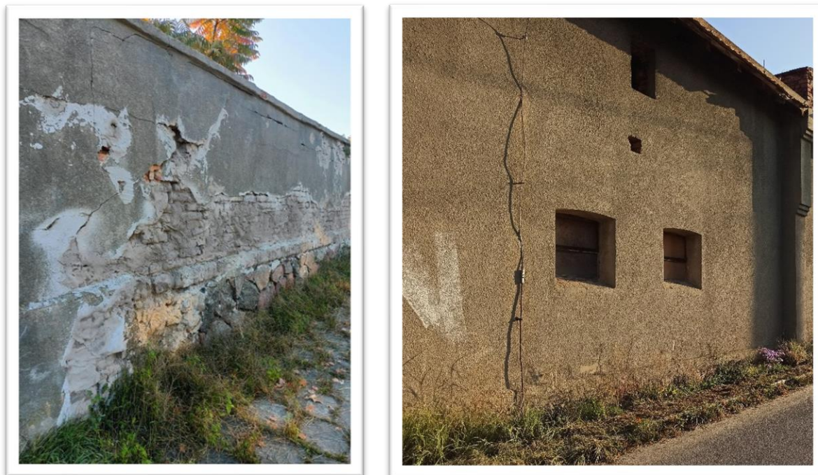
Rysunek 17 Stan techniczny obiektów budowlanych w podobszarze rewitalizacji 2 – miejscowość Chocieborowice (Jednostka 1).
