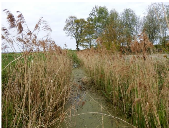
Fot. 25. Rów melioracyjny w złym stanie technicznym - obręb Lubiel
